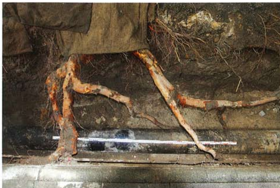
Wurzeleinwuchs an einer Gashochdruckleitung im Nahbereich von Platane
